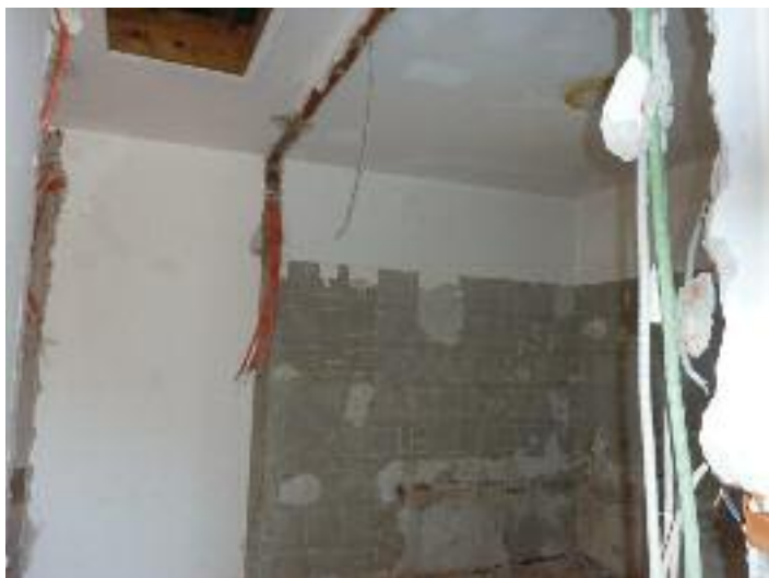
Una delle pareti abbattute, con l'impianto elettrico rimosso e i fili della luce a penzoloni. Un vero disastro
