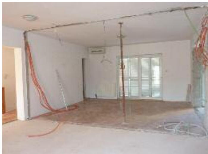
Due pareti abbattute e i pavimenti divelti hanno reso l'edificio inagibile
